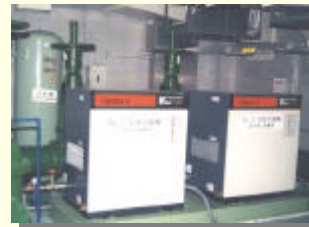
空気注入設備
